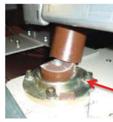
絶縁支柱が全損、設備の傾斜
