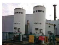
液体窒素貯槽の傾斜
