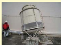
倒壊した冷却塔
