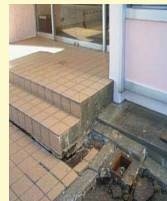
地盤沈下による段差
