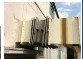
主排気ダクトベローズの変形
