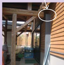
渡廊下部の分離
