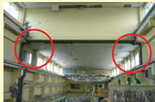
ホットラボの天井クレーンの損傷
