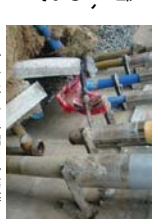
高144号-加速震研究機構(地盤沈下による配管損傷)
