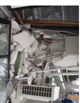
東北大学(柱の崩壊)
