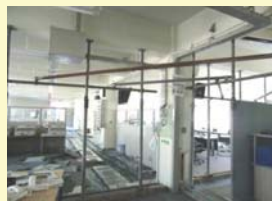
緊急時対策施設の損傷
